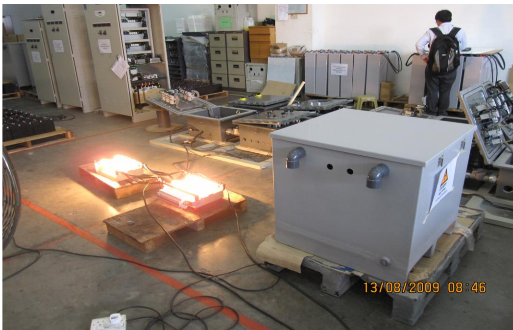
Hình 8: Kiểm tra thực tế hệ thống UPS dự án Đại Hùng
